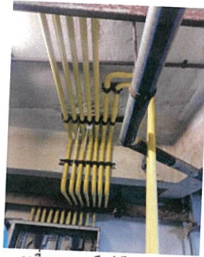
จุดที่ 13 แนวท่อน้ำร้อนที่โถกัลเพน
