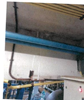
จุดที่ 17 แนวท่อน้ำร้อน
