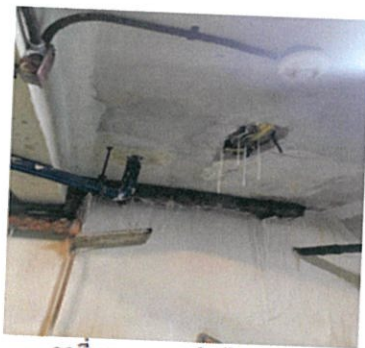
จุดที่ 15 เพดานกล่องไฟและท่อ
