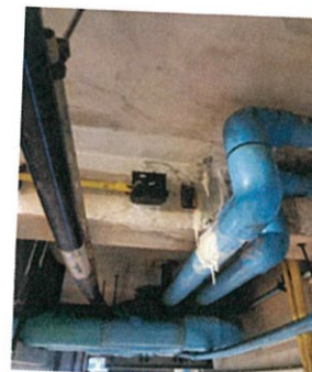
จุดที่ 19 แนวท่อน้ำร้อน
