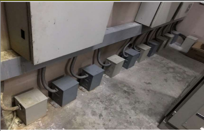
FA Item : P-05A-08-07-0015 : POWER FACTOR CONTROLLER BELUX รุ่น CX-6 ใช้ควบคุมระบบไฟฟ้าในอาคาร
