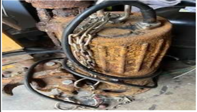
FA Item : P-05A-14-06-0010 : ปัมสูบน้ำ "TSURUMI" สำหรับ ระบบบำบัดน้ำเสียประตู 4
