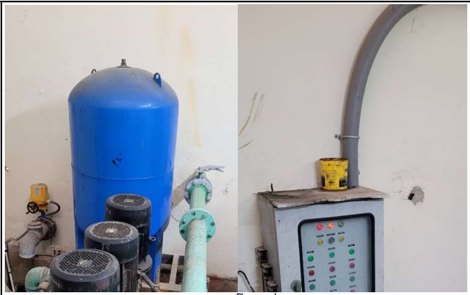
FA Item : P-05A-05-01-0001 : ปัมเครื่องยนต์มีตุ้มและมอเตอร์ 3 ตัว : PACKAGE BOOSTER PUMP SET
