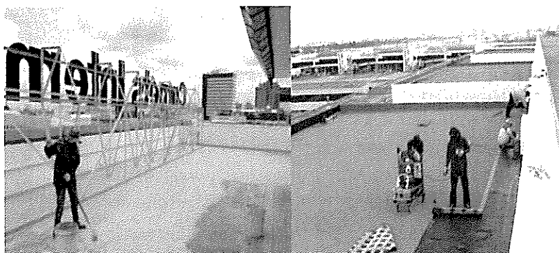
รูปที่ 3 วัสดุกันซึมบนดาดฟ้าด้วยการทาเคลือบหรือแผ่นสำเร็จรูป
